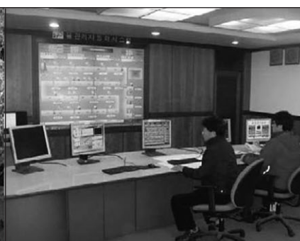
Phòng điều khiển trung tâm hệ thống quản lý nước
